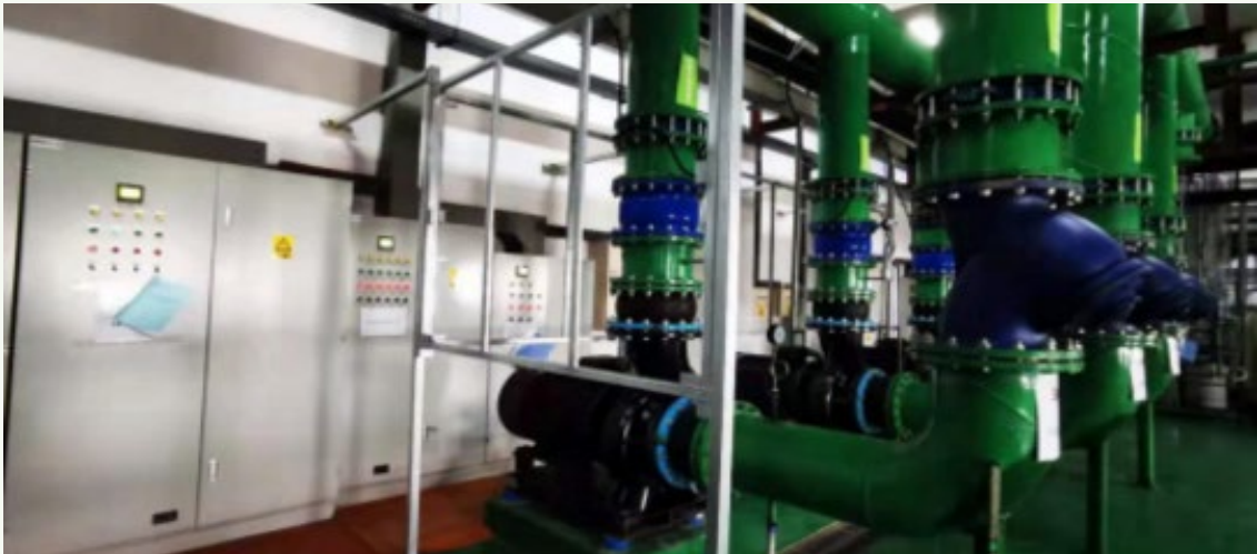
空调水泵变频系统
