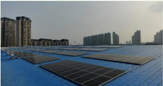
光伏发电项目
